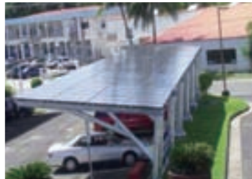
茂迪設置於帛琉醫院停車場之太陽能板，大幅降低用電成本
